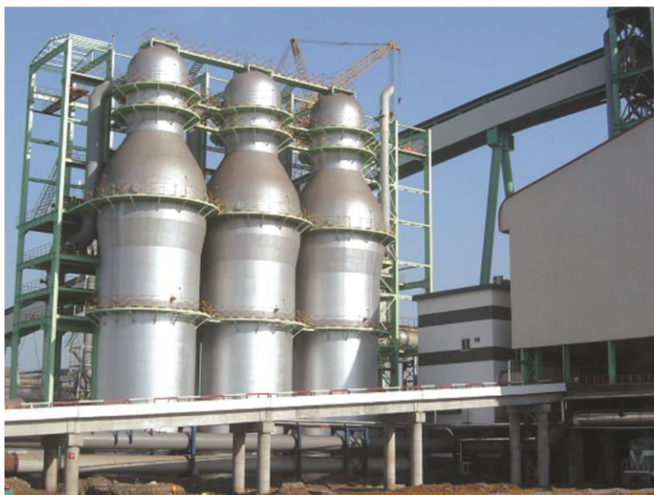
КИТАЙ. Цзинаньский меткомбинат. ДП объемом 1750 м 3 . Блок воздухонагревателей Калугина, в эксплуатации с 2003г. На этом комбинате введены в эксплуатацию блоки воздухонагревателей Калугина ещё на двух печах такого же объема.
