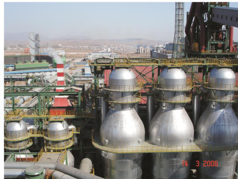
КИТАЙ. Шоугангский меткомбинат. ДП объемом 1160 м 3 . Блок воздухонагревателей Калугина, в эксплуатации с 2004г. Слева - малые воздухонагреватели Калугина, подогревающие воздух горения до 450 °С
