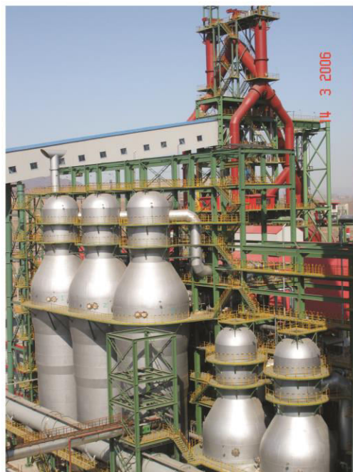
КИТАЙ. Шоугангский меткомбинат. ДП объемом 1780 м 3 . Блок воздухонагревателей Калугина, в эксплуатации с мая 2006г. Подогрев воздуха горения в малых ВНК (стоят справа) до 600 °С. Работает с температурой горячего дутья - 1250 °С и расходом пылеугольного топлива 200 кг/т чугуна.
