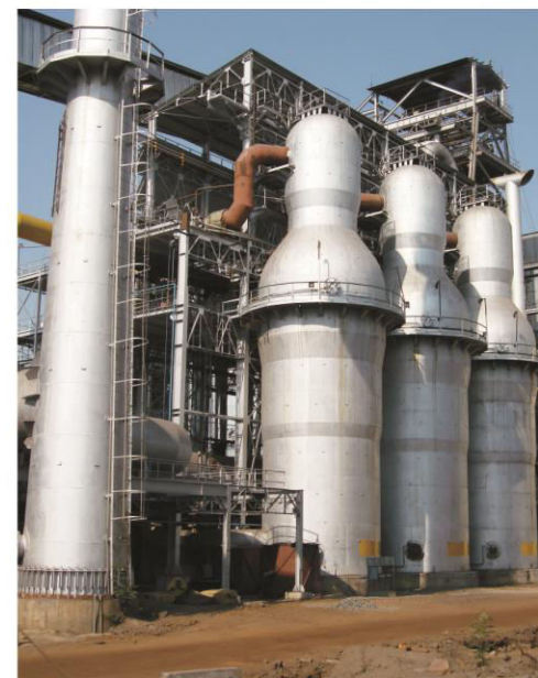
Индия. Метзавод "Сан Флаг" . ДП объемом 350 м 3 . Блок воздухонагревателей Калугина в эксплуатации с 2007г. Первый блок воздухонагревателей Калугина подстроенный в Индии.
